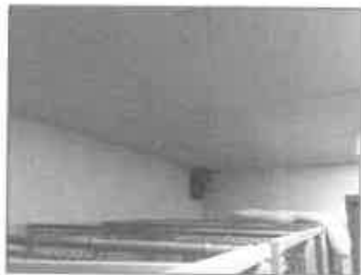
Exhaust Fan In Kennel
