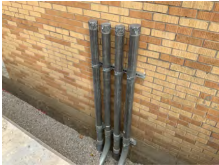
Underground Fiber Loop Conduit
