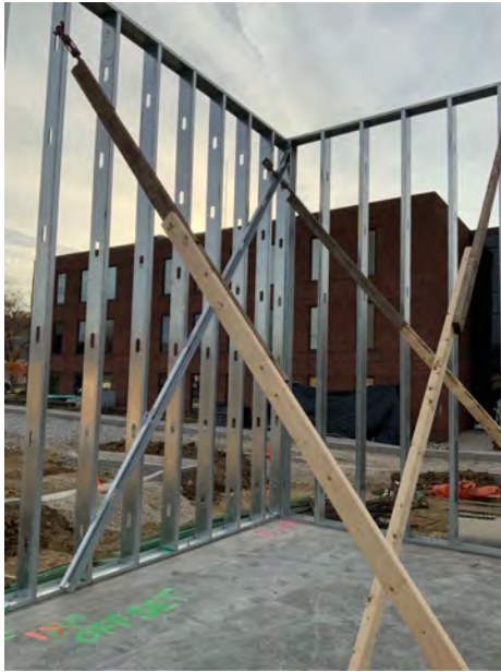
Metal Stud Wall Bracing
