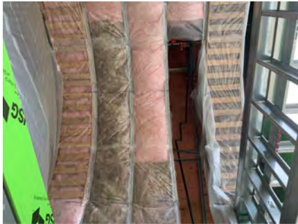
Non Freeze Sprinkler
